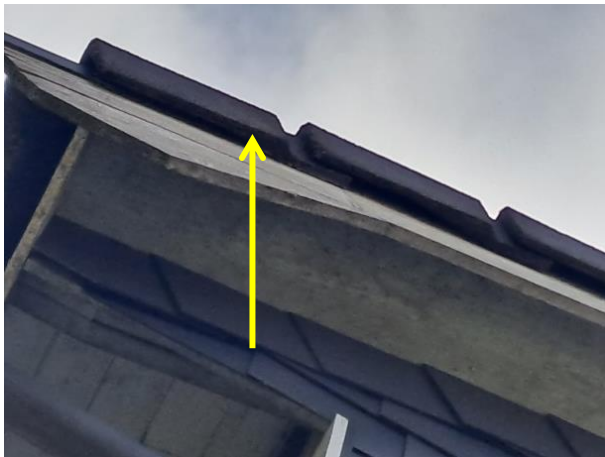
Abbildung 4: Spalten zwischen Ortgangziegel und Ortgangbrett.
